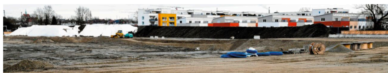
Hinter dem Dehner-Gartencenter an der Bgm.-Ackermann-Straße haben die Arbeiten für das Projekt Dehnerpark begonnen. Dort lag früher der Sportplatz des Post SV.
