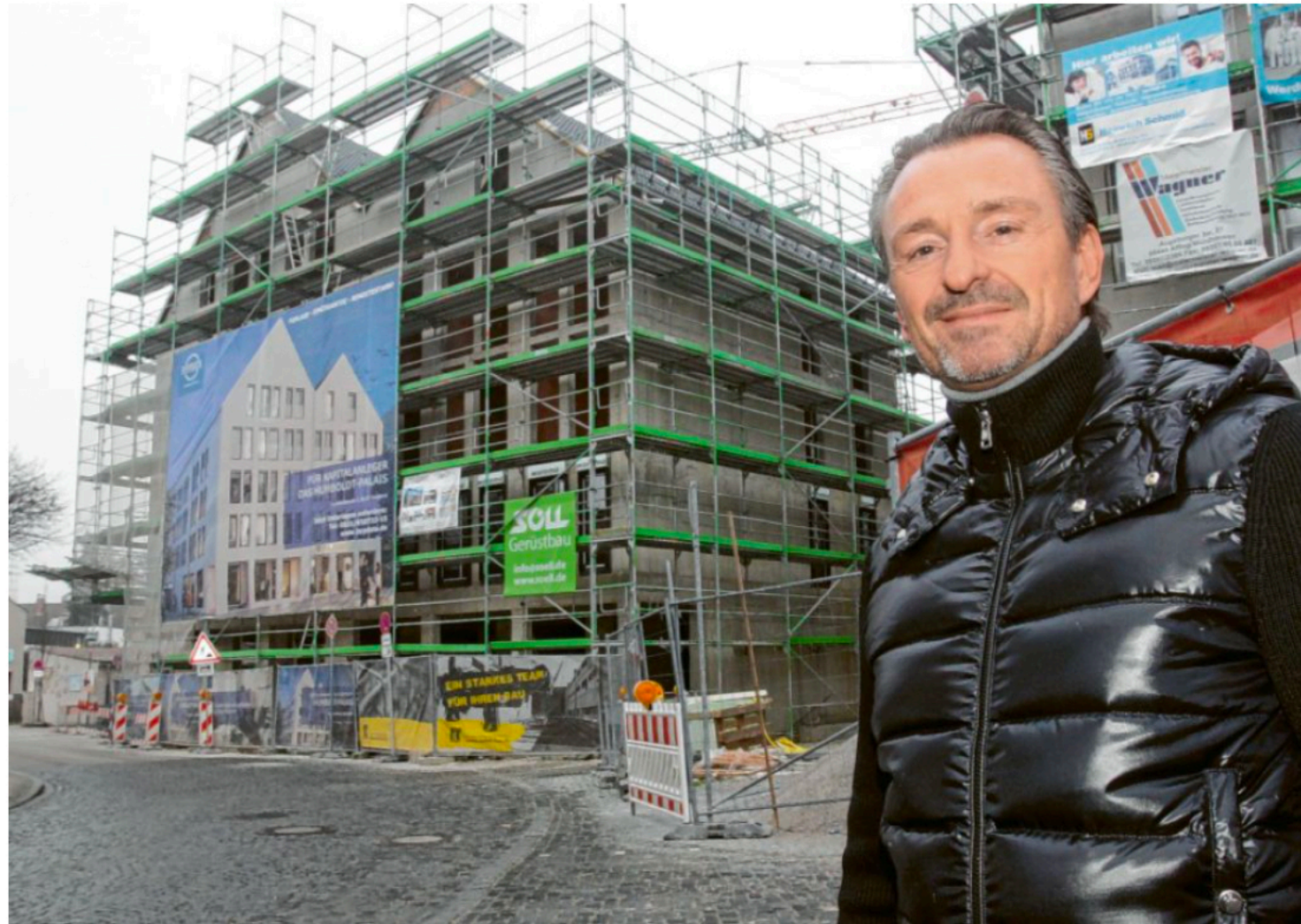
In einem ebenso ambitionierten wie realistischen Zeitplan liegt der Baufortschritte des Humboldt-Palais laut Jürgen Reitmeier, geschäftsführender Gesellschafter der Hypdata Immobilien GmbH. Mit dem nebenstehenden Neubau der Kirchenstiftung St. Pankratius bilde es ein „schickes“ Ensemble im Lechhauser Zentrum. Foto: Annette Zoepf
