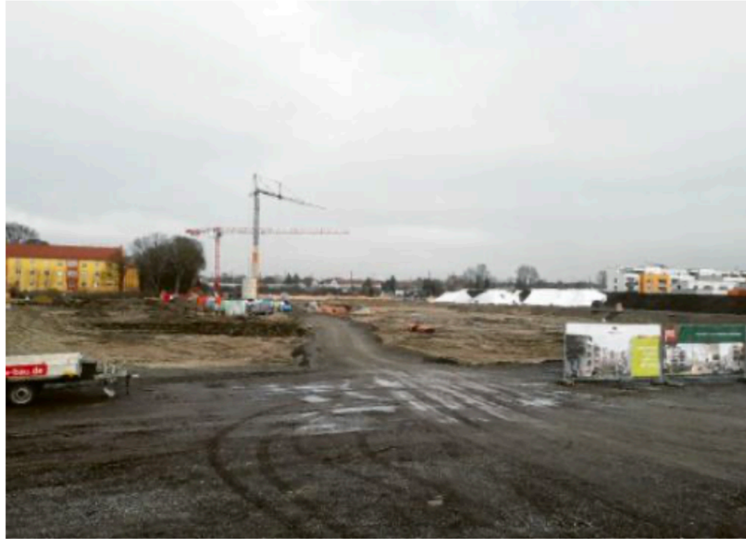
Wo früher der Post SV sein Trainingsgelände hatte, liefen in den vergangenen Monaten schon Erdarbeiten. Bis 2023 soll das ganze Areal bebaut sein, so die Planungen.
